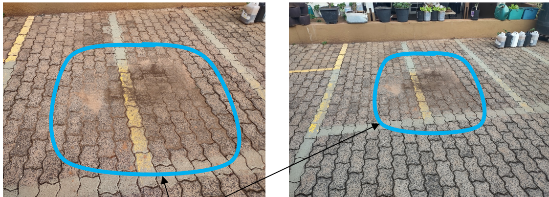
Área de depressão (afundamento) com empoçamento de águas pluviais (4 m 2 ).
